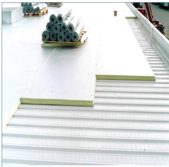
Рисунок 1: Пример конструкции крыши, состоящей из стального настила, теплоизоляции на основе полиизоцианурата (PIR) и кровельного покрытия.
