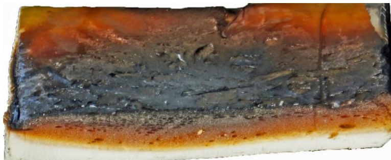
Рисунок 26. Тип повреждения ПИР4 теплоизоляционного материала при натуральных огневых испытаниях фрагмента фасада со стальной облицовкой, расположенной с воздушным зазором 25 мм (на фотографии образец повернут в горизонтальное положение, облицовка не показана). Температура обогреваемой стороны облицовки – 920°C, время – 15 мин (рис. авт.)
