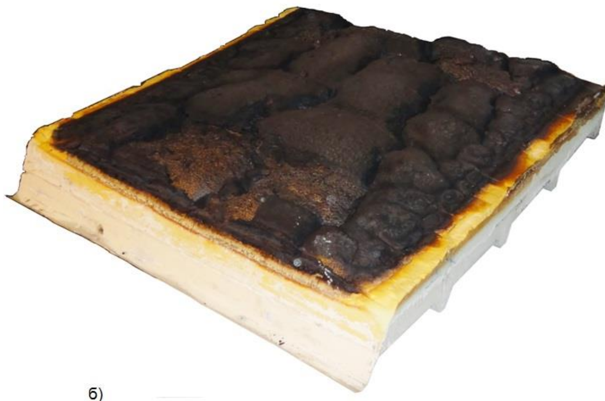
Рисунок 31. Повреждения типа ПИР7 для поверхности в форме крупных агломератов без трещин со стороны огневого воздействия на стены (а) и покрытие (б) из сэндвич – панелей (стальные обшивки сняты) при испытании на огнестойкость по ГОСТ Р 56076-2014 (время огневого воздействия – 15 мин) (рис. авт.)
