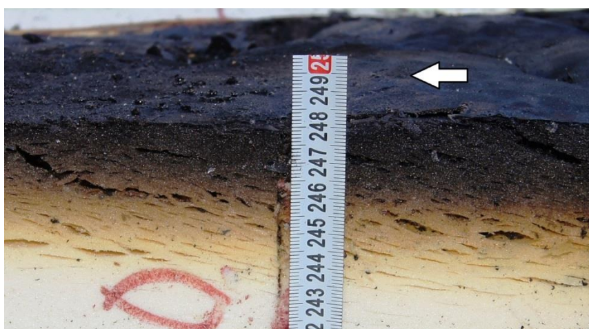
Рисунок 25. Тип повреждения ПИР4 теплоизоляционного материала у начала контрольной зоны при испытании на пожарную опасность стены из сэндвич-панелей по ГОСТ 30403-2012 (класс пожарной опасности строительной конструкции – К2(15), характеристики ПИР – Г3, В2, Д2, Т4, КМ5). Стальная обшивка демонтирована. Стрелкой показано направление теплового потока над поверхностью (справа налево). Щели наклонены навстречу теплому потоку (ориентированы по изотермам). На поверхности - однородная корка (рис. авт.)
