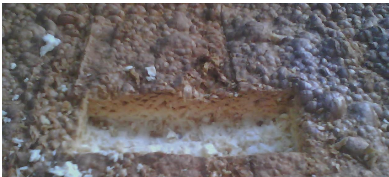
Рисунок 28. Тип повреждения ПИР5 теплоизоляционного материала (группа горючести – Г2) сэндвич-панелей (стальная обшивка демонтирована), показанный вырез выполнен в контрольной зоне после испытания покрытия на пожарную опасность по ГОСТ 30403-2012, класс пожарной опасности строительной конструкции - К1(15) (рис. авт.)
