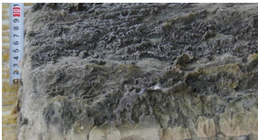
Рисунок 18. Оплавление MB и выгорание при натуральных огневых испытаниях по ГОСТ Р 56076-2014 (стена фрагмента здания из сэндвич-панелей, время огневого воздействия – 15 мин, толщина повреждённого материала 50 мм при толщине до испытания – 100 мм, тип повреждений – MB2) (рис. авт.)
